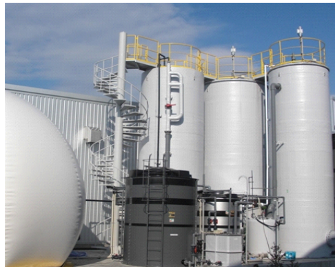
50m 3 /日メタン発酵処理装置
